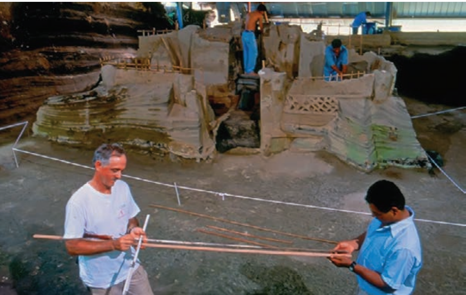
76 Estructura 12. Casa de la shamana o adivina en Joya de Cerén. Se comunicaba con su clientela a través de una ventana de celosía. Al fondo, trabajadores refuerzan la estructura.
